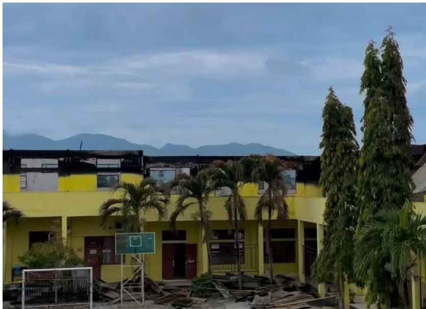
Gambar 1. Bangunan sekolah yang terbakar
